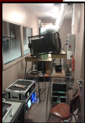
Seconde installation avec gaine et extracteur installés dans le faux-plafond pour éviter la surchauffe
